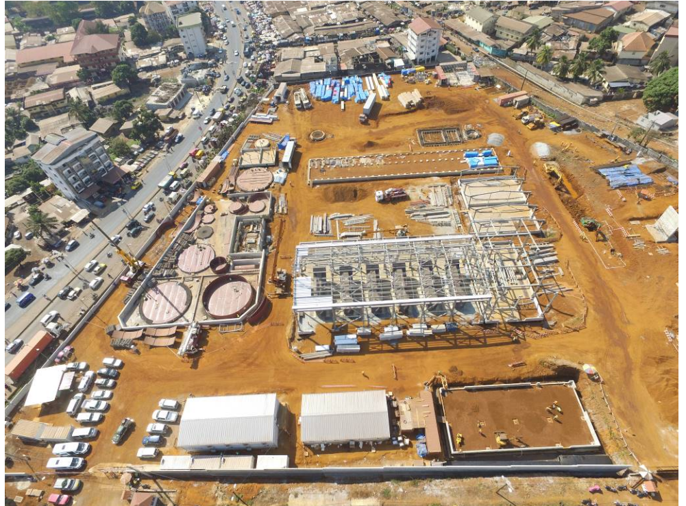
MAN Energy Solutions installiert sechs MAN 18V32/40-Motoren mit einer Gesamtleistung von 53 MW in einem Kraftwerk in Conakry, Guinea.
