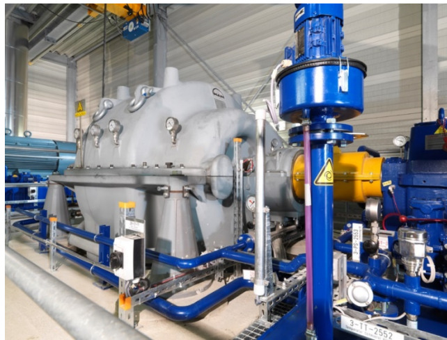
TURBAIR ® -Vakuumgebläse des Typs RC im Einsatz bei UPM Nordland Papier in Dörpen (Deutschland)
